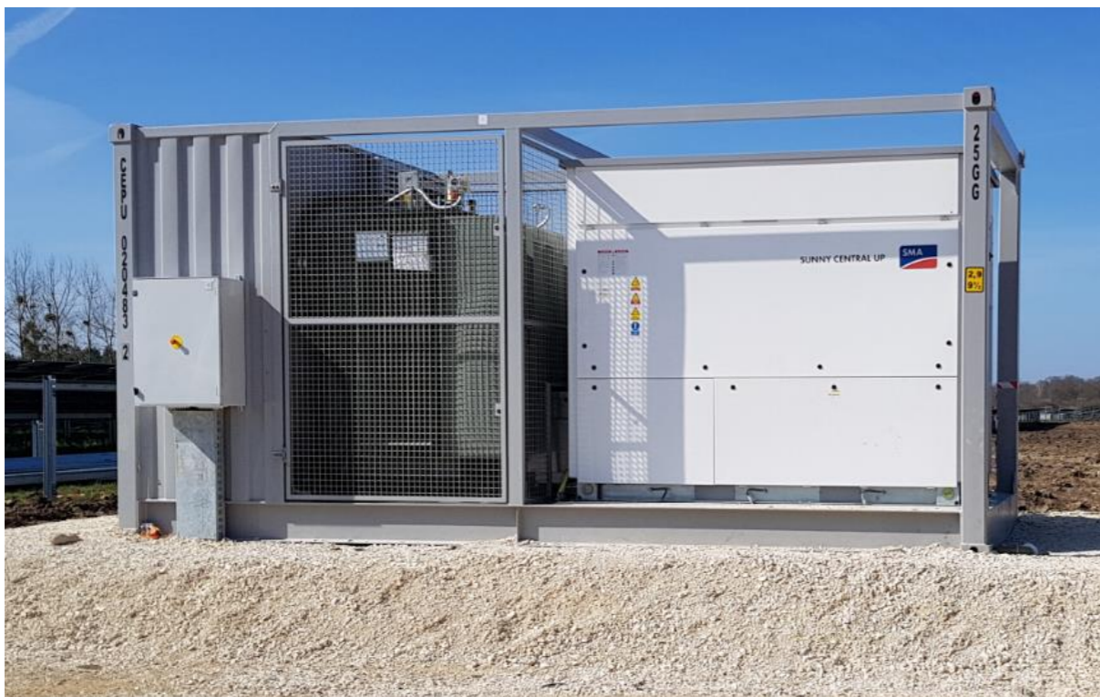
Figure 142 : Poste de transformation
